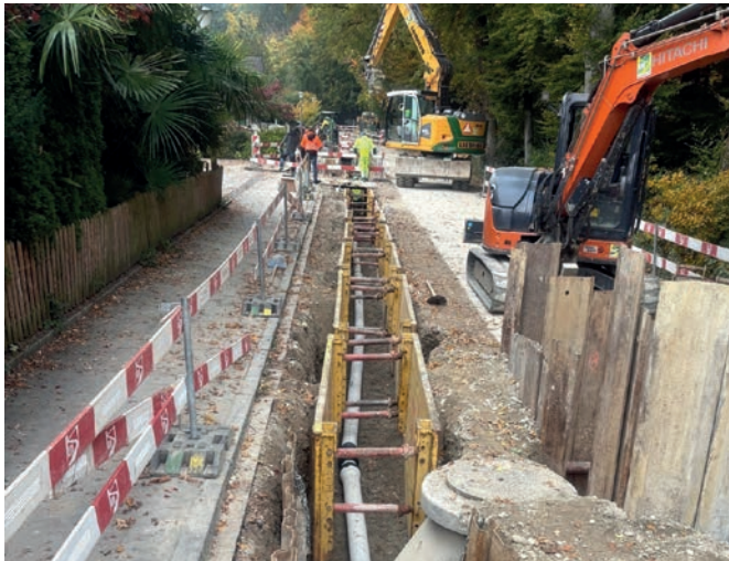
Wasserleitung, Waldstrasse, Pfaffhausen
