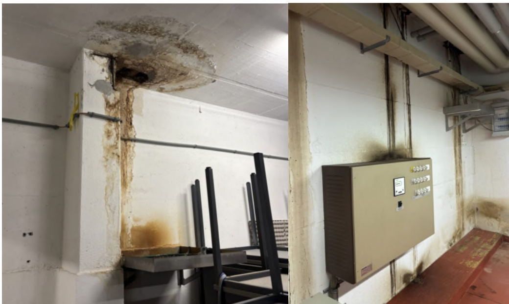
Abbildung 3: Wassereintritte im Untergeschoss
