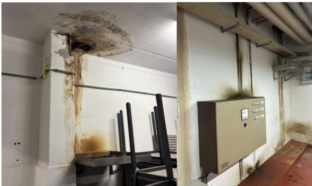
Abbildung 3: Wassereintritte im Untergeschoss
