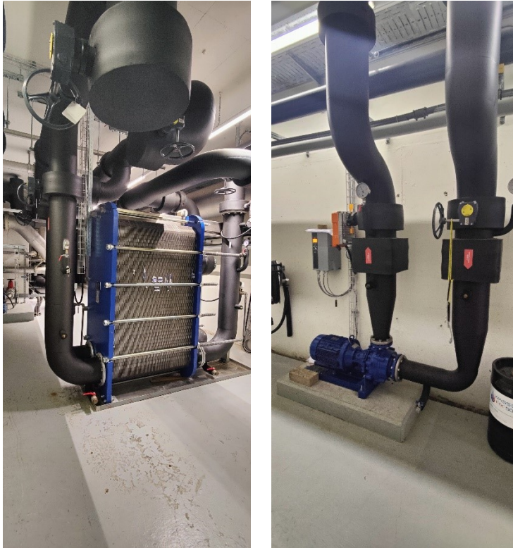
Abbildung 4: Anlagenteile bestehende Wärmezentrale auf ARA Bachwis
